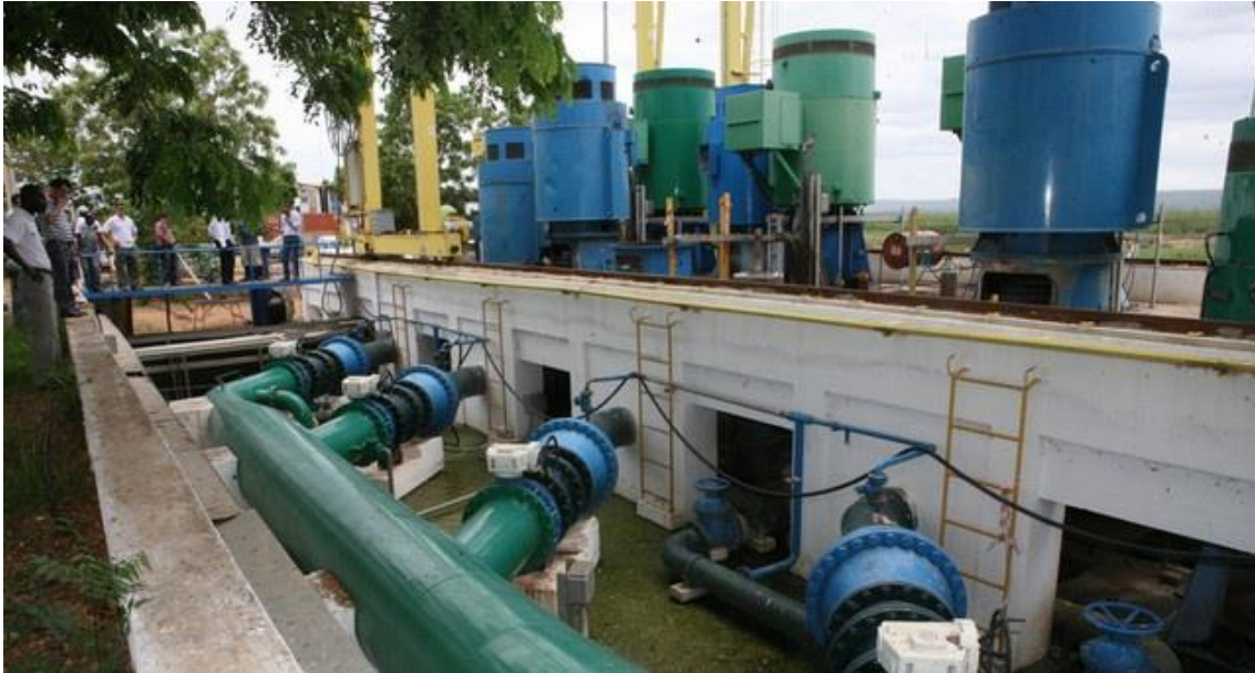
CENTRO DE BOMBAGEM DE ÁGUA DA EPAL (ARQUIVO)
