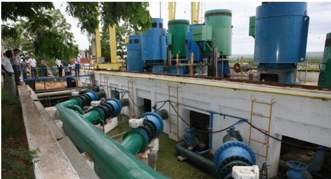
CENTRO DE BOMBAGEM DE ÁGUA DA EPAL
